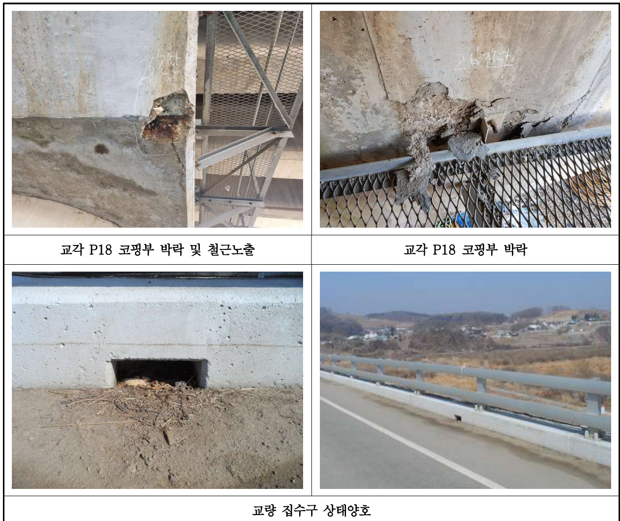
【사진 3.33】 교량의 공중이용시설 10대 위험요소 손상현황
