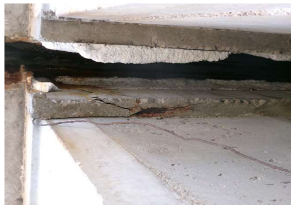
S6 바닥판하면 파손 및 철근노출
