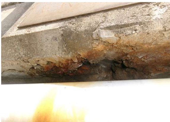
S4 바닥판하면 파손 및 철근노출
