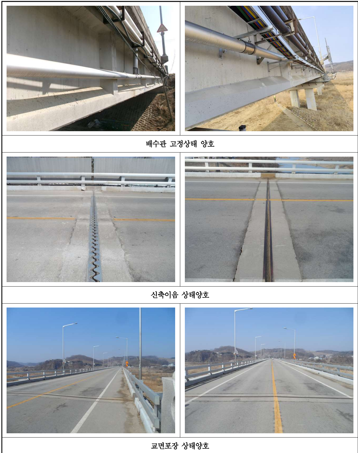
【사진 3.33】 교량의 공중이용시설 10대 위험요소 손상현황(계속)
