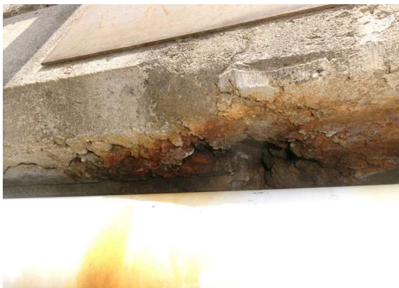
S4 바닥판하면 파손 및 철근노출
