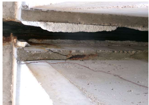
S6 바닥판하면 파손 및 철근노출
